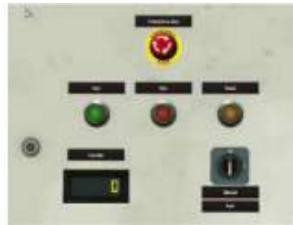
Figura 10.5. Puerta del cuadro de control.
